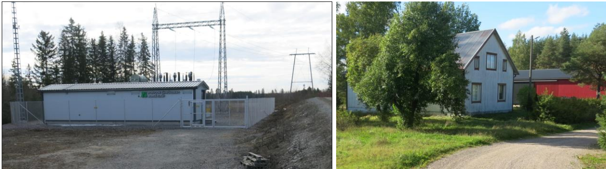
Alueella on 110 kV:n muuntoasema.
