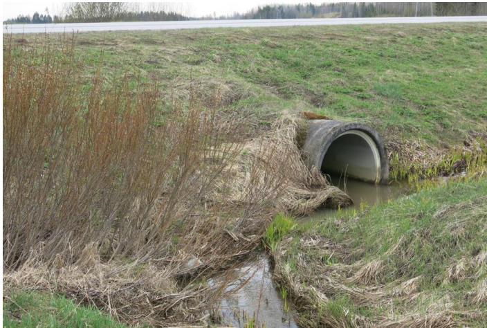
Kuivatusojan rumpu maantien ali.
