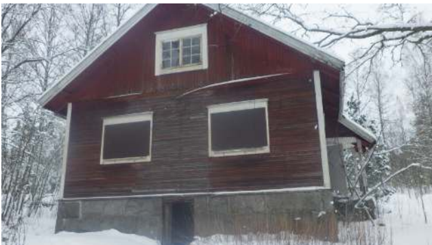
8. Julkisivua, päätykolmiossa lahovaurioita
