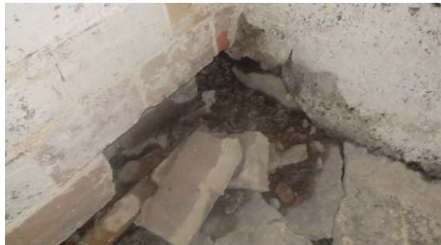
6. Kellarin seinän alaosa ja lattia rapautuneet
