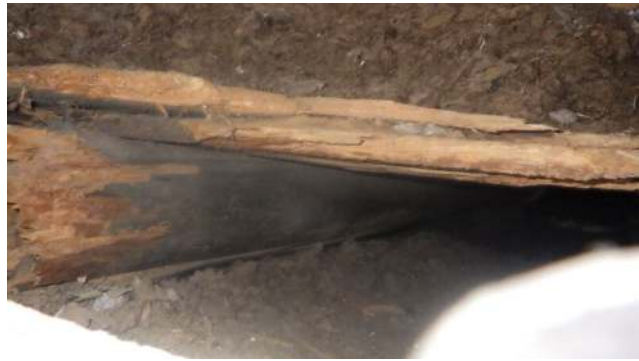
2. Alapohjassa lahoa ylärinteen puoleisella nurkalla
