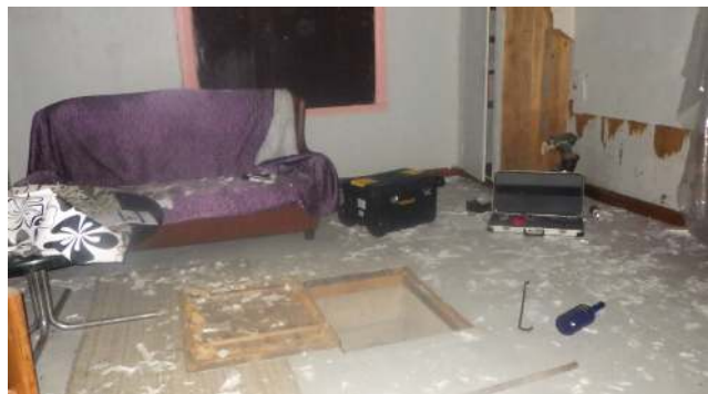
25. Sisätilat ovat peruskorjattavassa kunnossa
