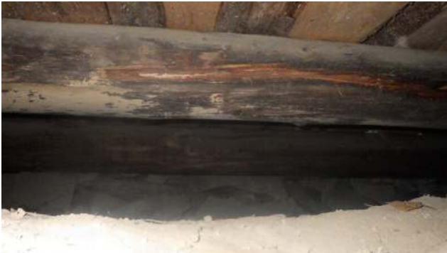
3. Alapohjarakenteissa tummumaa (tuuletusaukosta otettu kuva)
