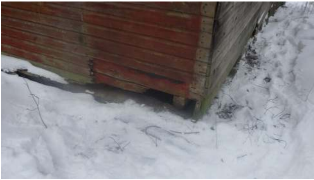
1. Ulkoseinä lahonnut ylärinteen puoleisella nurkalla
