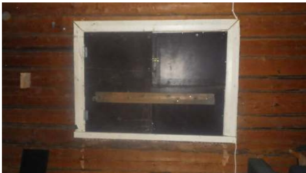
22. Sisätilat ovat peruskorjattavassa kunnossa
