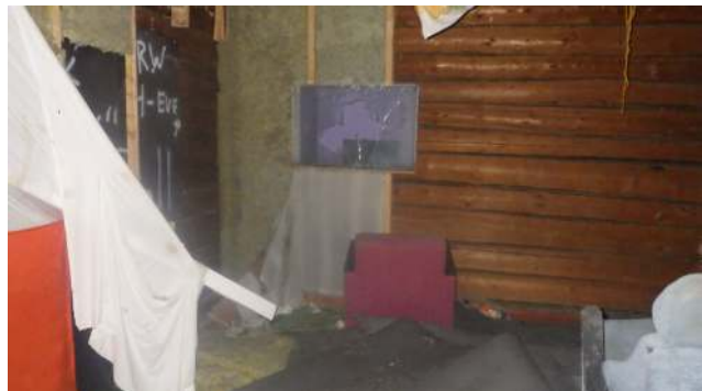
23. Sisätilat ovat peruskorjattavassa kunnossa
