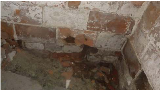
7. Kellarin seinän alaosa ja lattia rapautuneet
