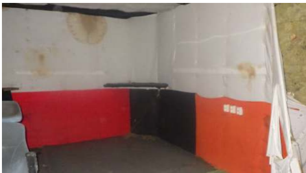
24. Sisätilat ovat peruskorjattavassa kunnossa
