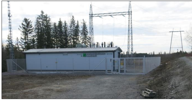
Alueella on 110 kV:n muuntoasema.
