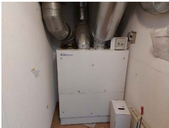
34. Rakennuksessa on kaksi samanlaista ilmanvaihtokonetta.
