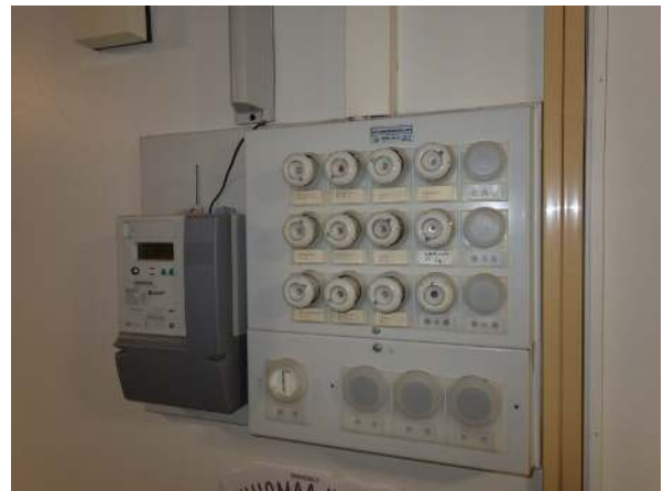
41. Alkuperäinen ryhmäkeskus sähkömittareineen.
