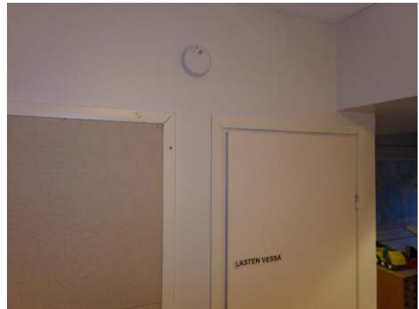
53. Väärin asennettu palovaroitin.
