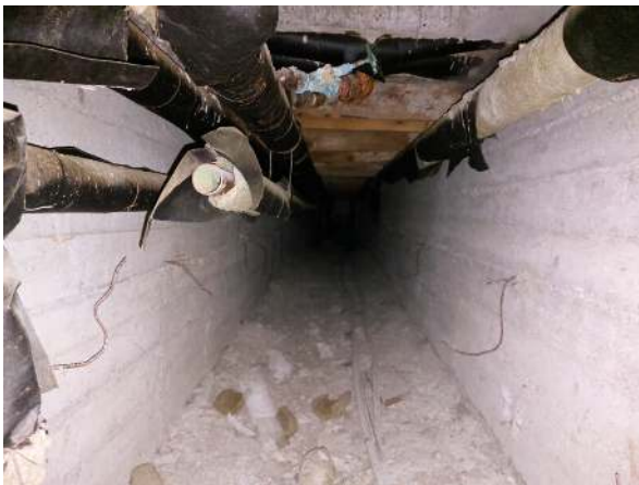
4. Tekniikkakuilua, teräsosissa ruostevaurioita.
