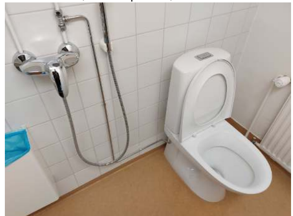
33. WC kalusteita (uudempia).
