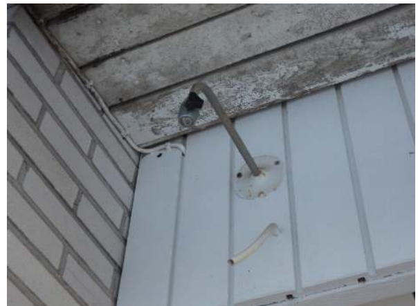
47. Käytöstä poistetut sähköjohdot tulee rasioida tai poistaa kokonaan.
