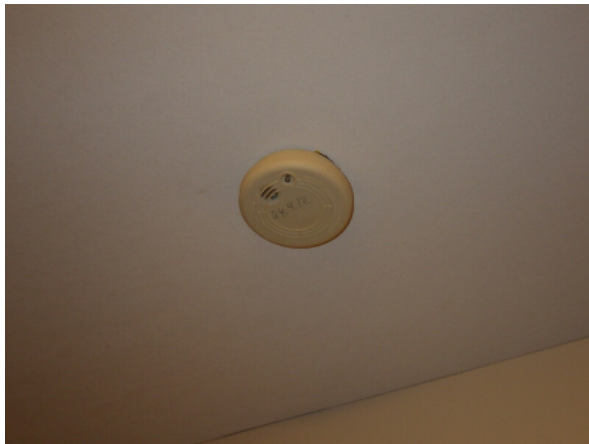
52. Ikääntynyt palovaroitin (asennettu 24.4.2012).
