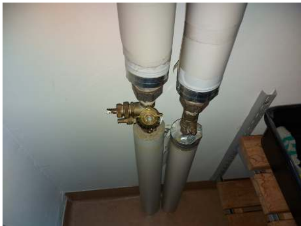
24. Linjasäätö- ja sulkuventtiilipari.
