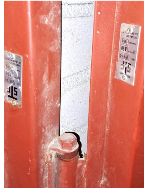
Kuva 4. Kuva palo-oven tyyppikilvestä. Kyseinen palo-ovi valmistettu 1988.
