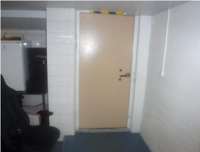
Kuva 3. Vanha palo-ovi tilassa 030. Ovesta käynti porraskäytävään. Palo-oven tyyppitunnuksen perusteella ovi valmistettu 1967.
