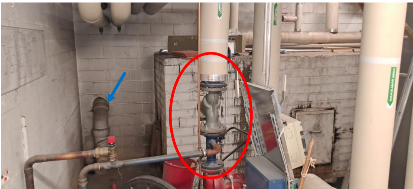
Kuva 7. Laippaliitoksia lämpökeskuksessa 042 punaisella ympyröitynä. Sinisen nuolen kohdalla vanhaa valurautaviemäriä.
