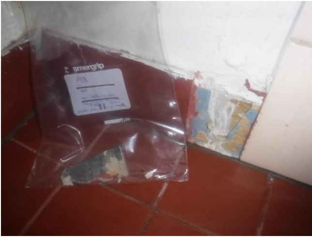
Kuva 17. WC:n 160, 10x10 punainen lattialaatta, kiinnitys- ja saumauslaasti, sinertävä muovimatto sekä kiinnityслиima eivät sisällä asbestia (ASB9)
