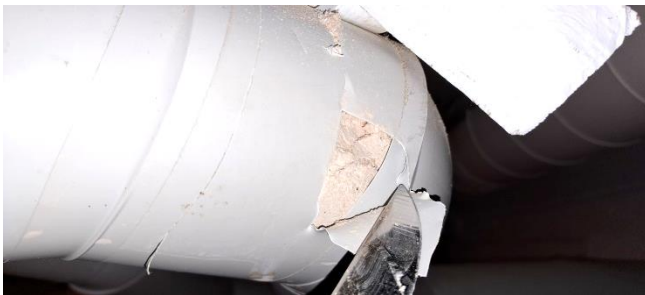
Kuva 1. Nurkkaosan putken pinnan eriste sisältää asbestia.
